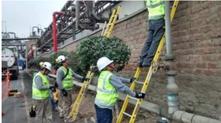
Figura 6. Seguridad en instalación de FO [9]
